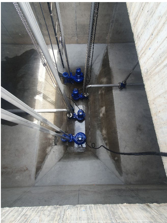
Figura 5 – Intervento O-14: nuove pompe e airjet (vasca OPIR).
