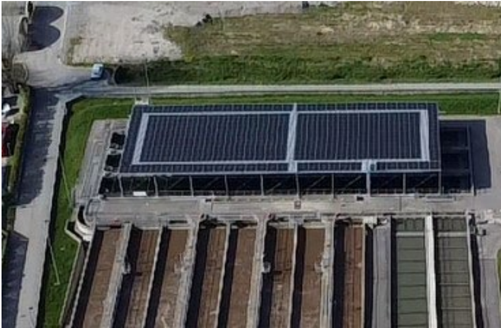
Figura 16 – Nuovo impianto fotovoltaico.
