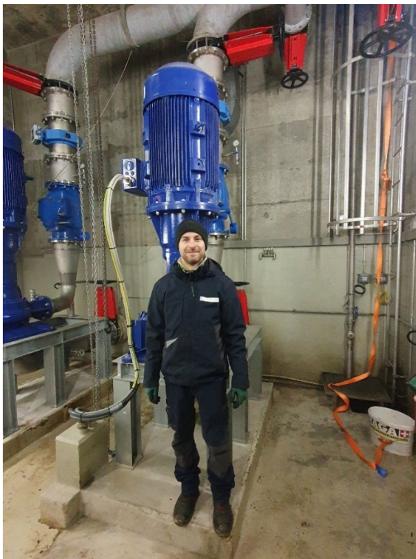
Figura 4 – Intervento S-09: nuove pompe Laveggio.
