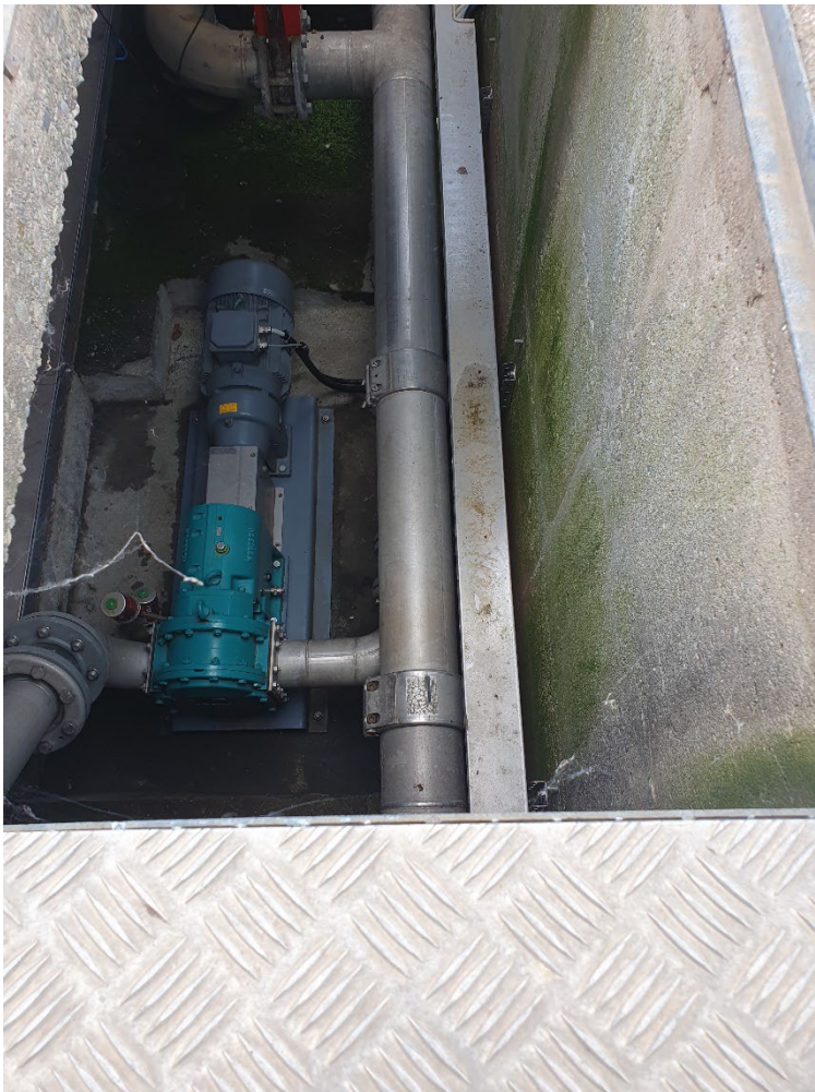
Figura 1 – Pompa fanghi primari.
