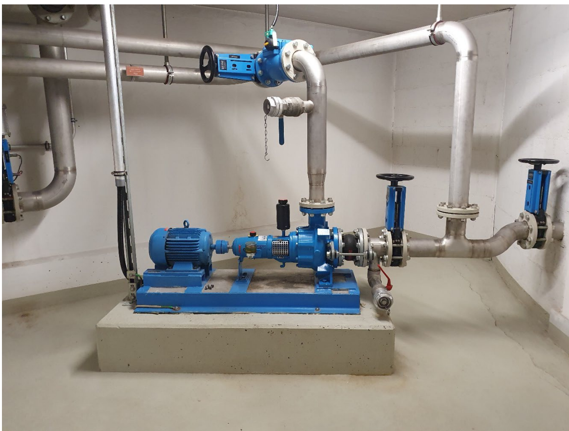
Figura 6 – Pompa ricircolo fango digerito.
