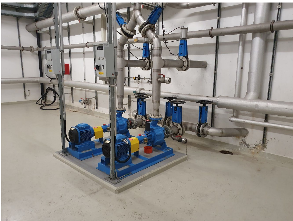
Figura 3 – Pompe fango preispessito.
