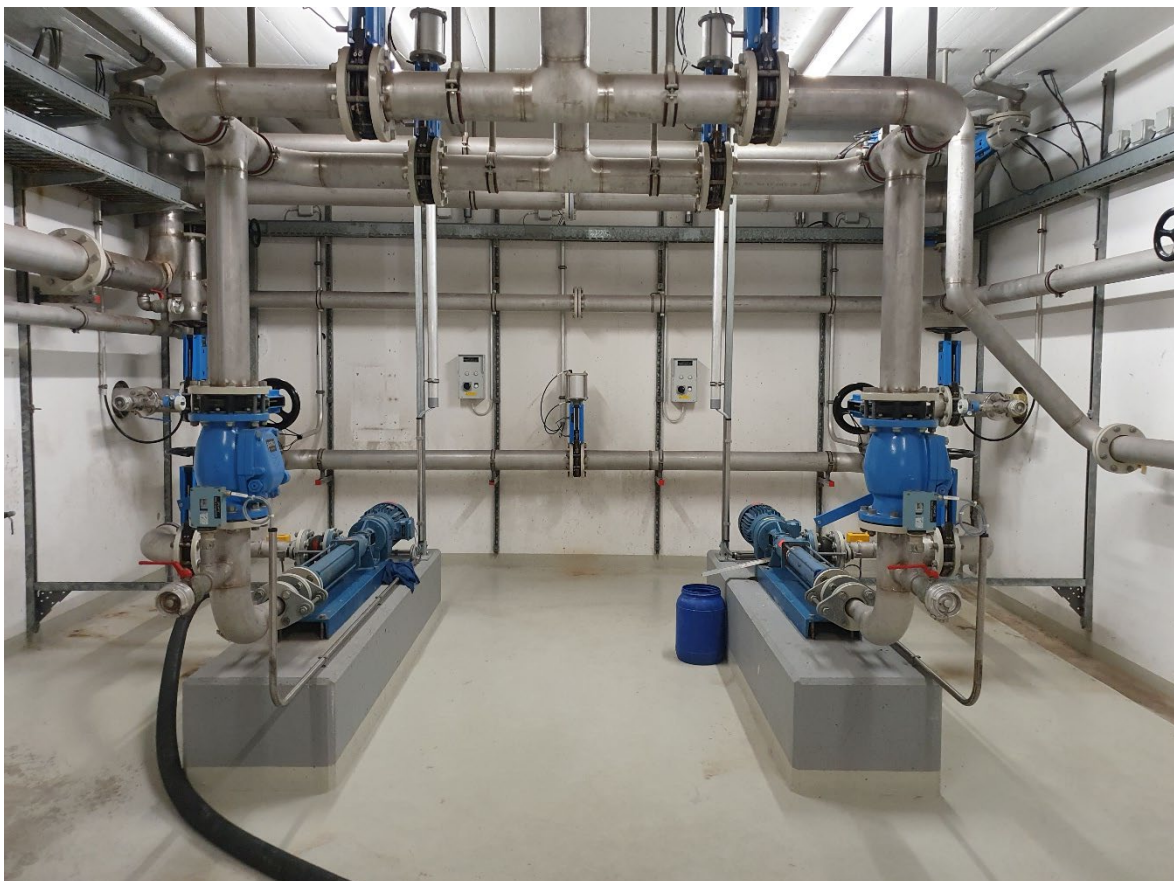
Figura 7 – Pompe fango ispessito.
