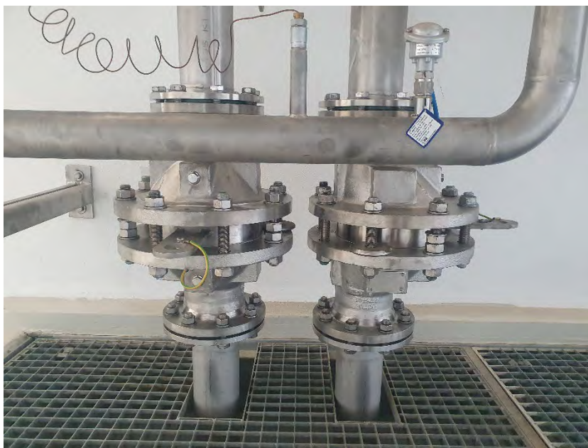
Figura 10 – Nuove valvole rompifiamma locale trattamento gas.
