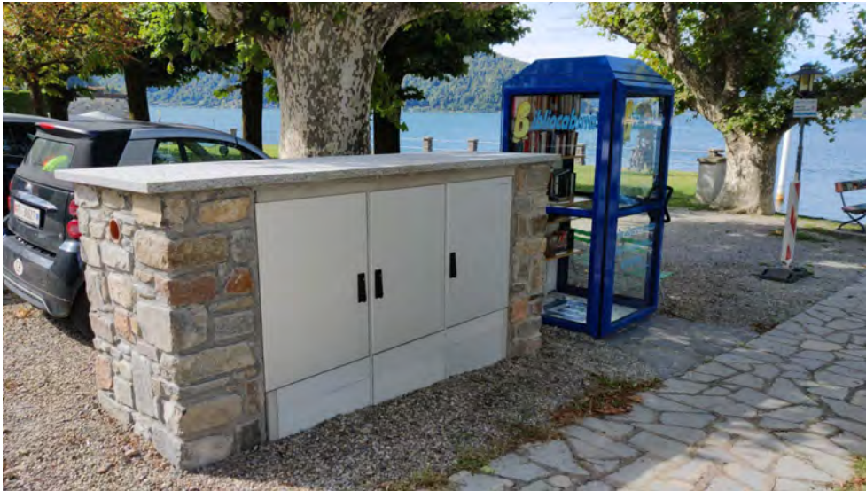
Figura 5 – Nuovo quadro di alimentazione CDAM/Comune.
