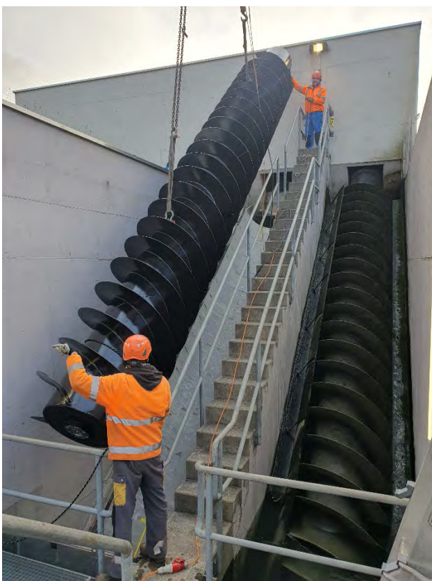
Figura 15 – Posa vite 1 filtrazione risanata.
