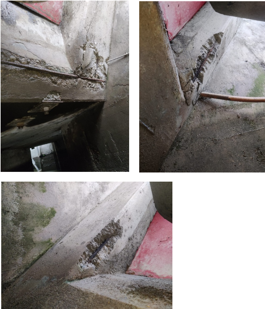
Figura 3 – Esempi di ferri d'armatura esposti.
