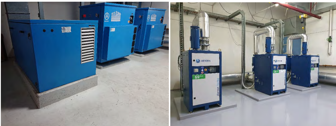
Figura 15 – Vecchie e nuove soffianti aerazione biologia (1 linea).
