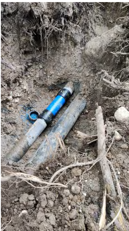
Figura 4 – Maggio: ennesima riparazione puntuale della condotta premente ad Arzo.
