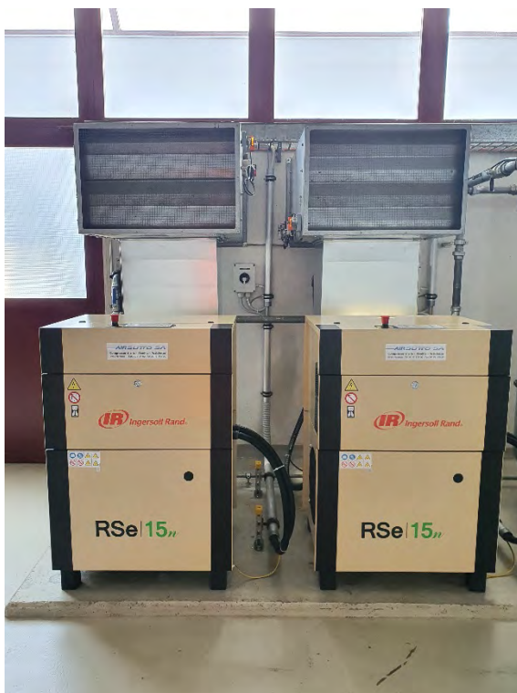
Figura 14 – Nuovi compressori filtrazione.
