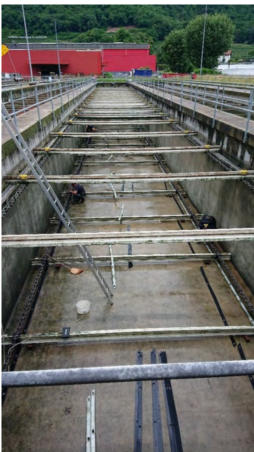
Figura 23 - Sostituzione catene e organi di trazione sedimentatori.
