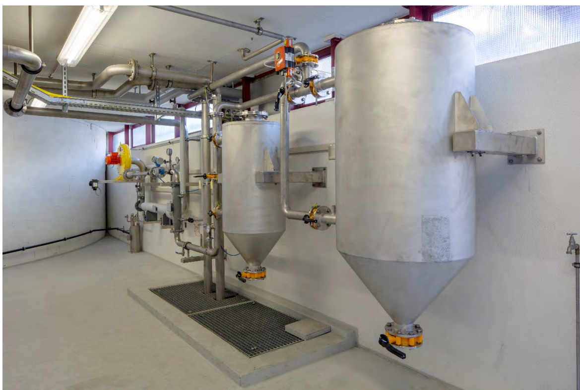
Figura 26 - Nuova linea di trattamento gas.
