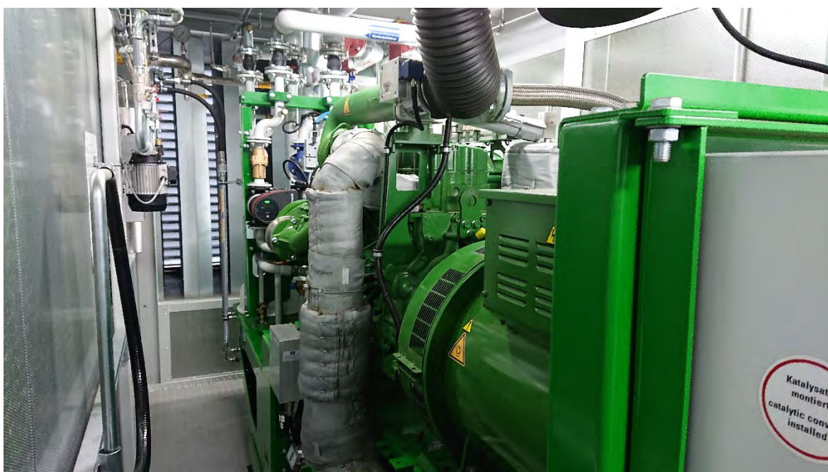
Figura 28 - Nuovo cogeneratore AIM.
