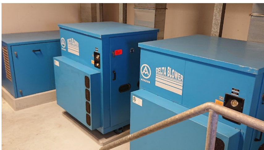
Figura 10 – Soffianti linea 2 biologia.
