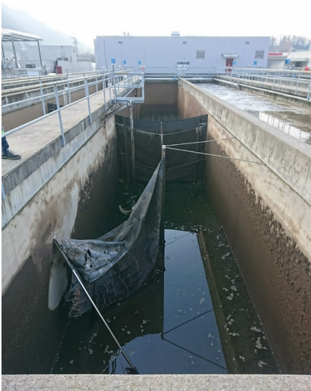
Figura 4 – Telo longitudinale rotto.
