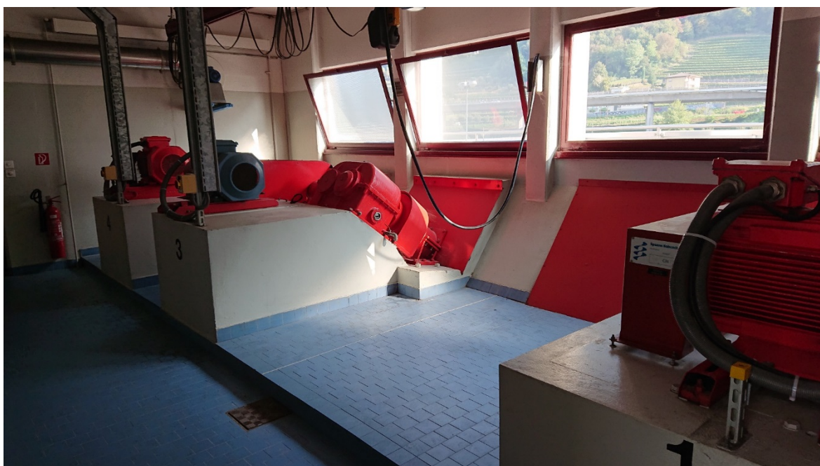
Figura 2 – Locale motori viti di sollevamento.
