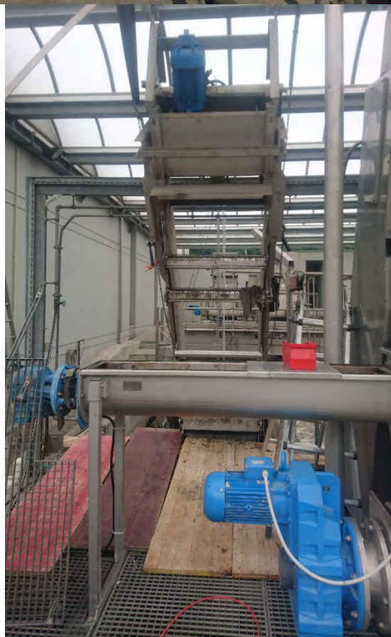
Figura 38 – Griglie fini: nuovo compactatore e servizio.
