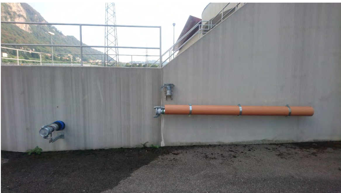
Figura 51 - Nuovo punto di scarico fanghi esterni.
