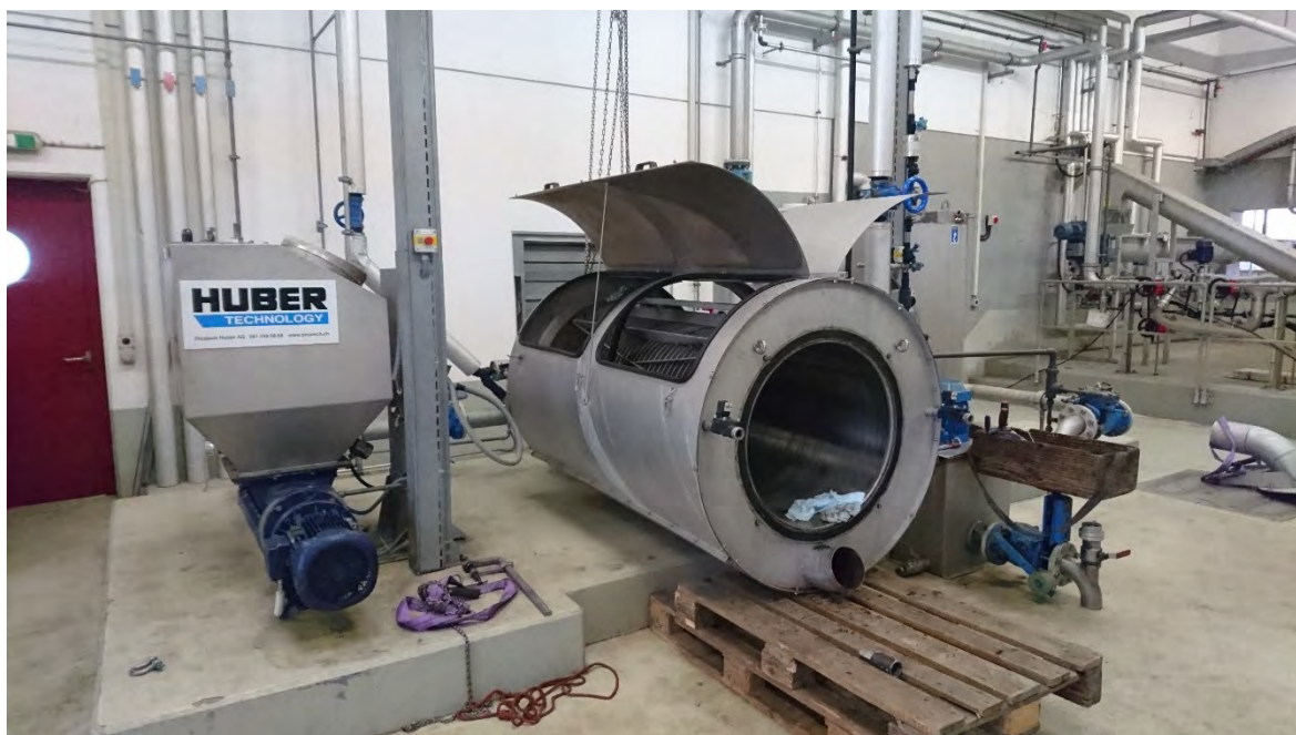
Figura 49 - Manutenzione all'ispessitore dei fanghi di supero.
