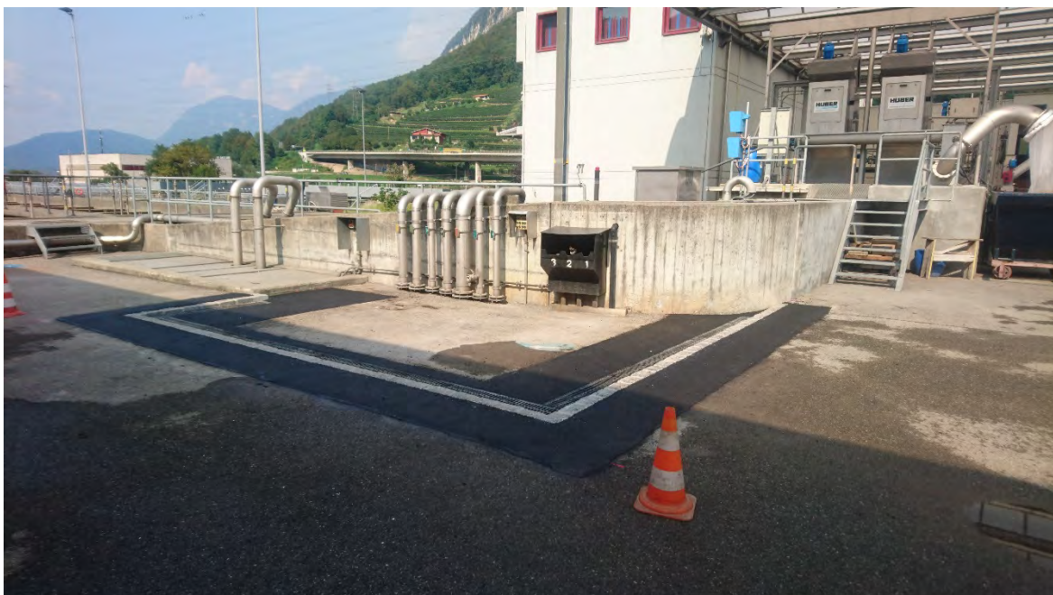
Figura 53 - Messa in sicurezza punto di scarico flocculante.
