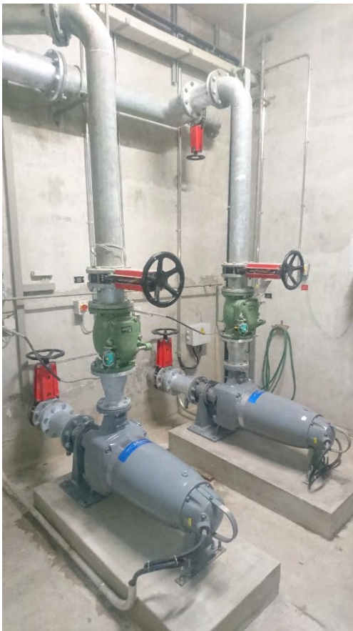
Figura 9 - Nuove pompe e tubazione stazione di pompaggio di Arzo.
