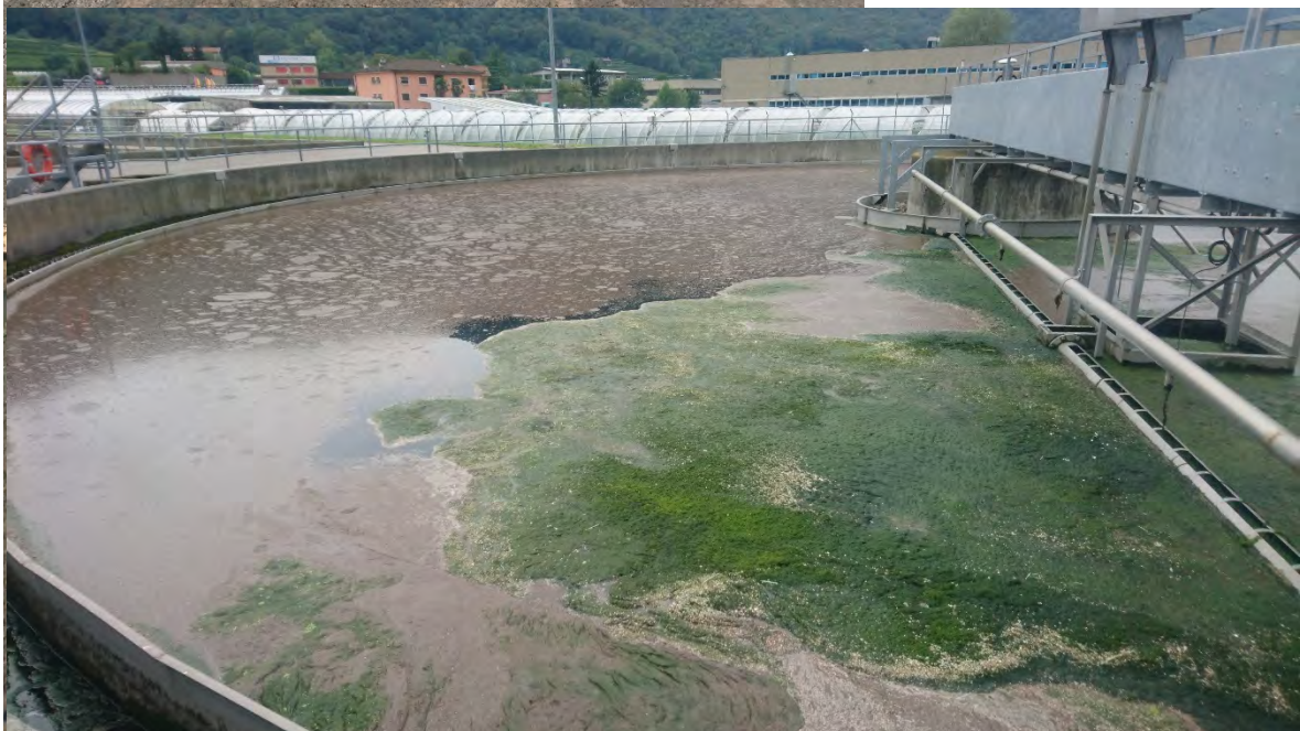
Figura 41 - Risalita fanghi in decantazione primaria (in alto) e secondaria.
