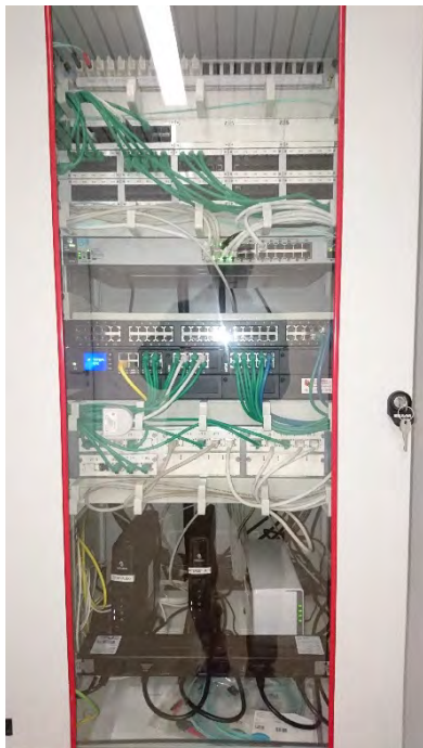
Figura 42 - Quadro nuova centrale telefonica e rete informatica presso gli uffici.
