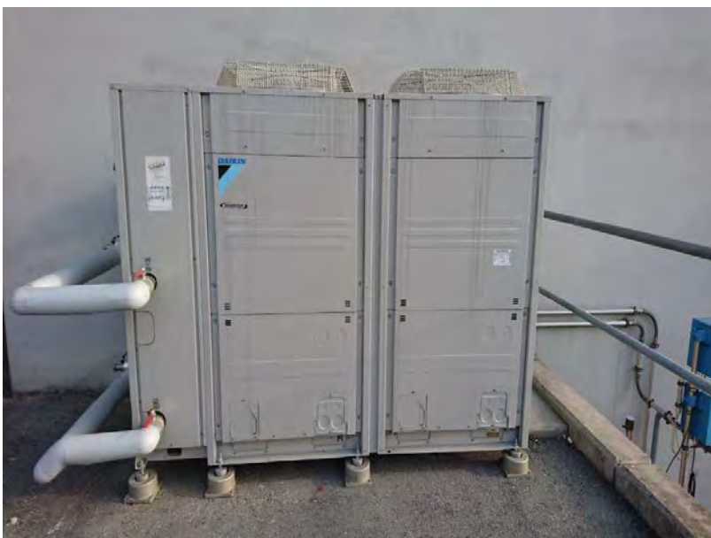
Figura 40 - Nuovo condizionatore uffici.
