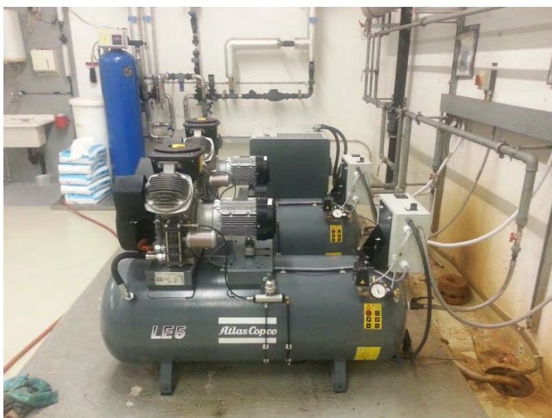
Figura 36 - Nuovi compressori aria servizi.
