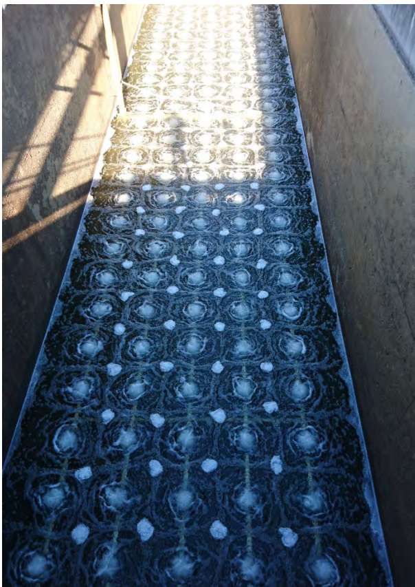
Figura 38 - Prova di funzionamento dei piattelli di aerazione biologia 4.
